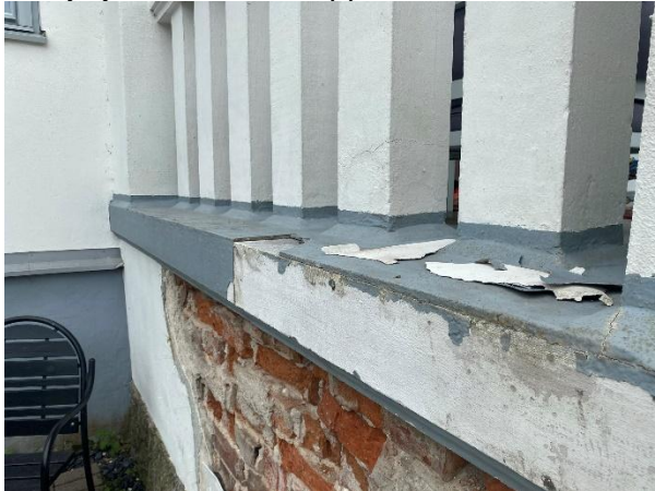
Skada på upphöjd sockel vid terrass
